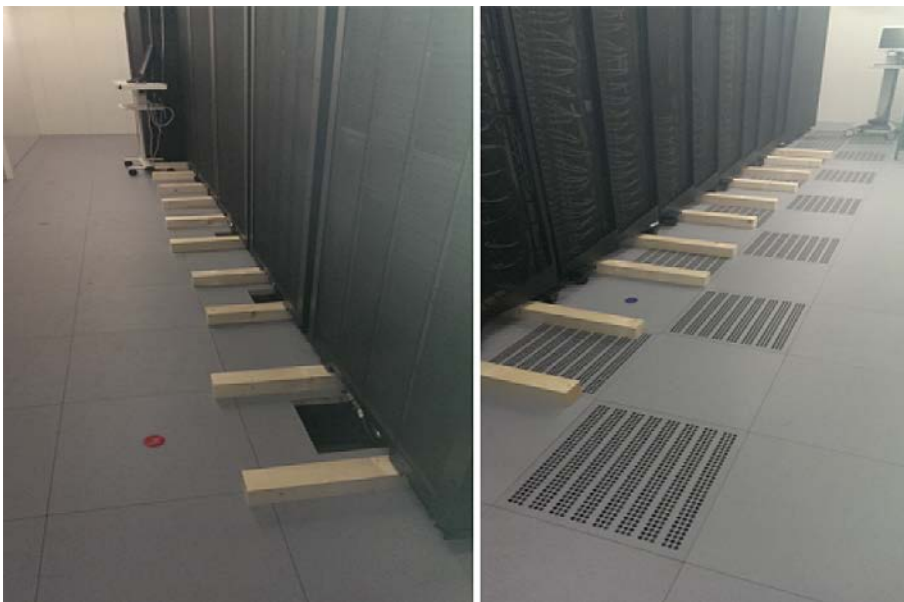
(8) Rettungsaktion einer schweren Rackreihe auf einem unterdimensionierten Doppelboden
