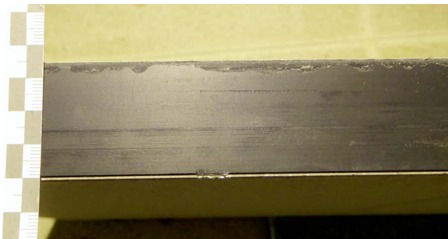
(14) Beispiel einer Plattenkante mit Überbeschichtung durch Grundierung
