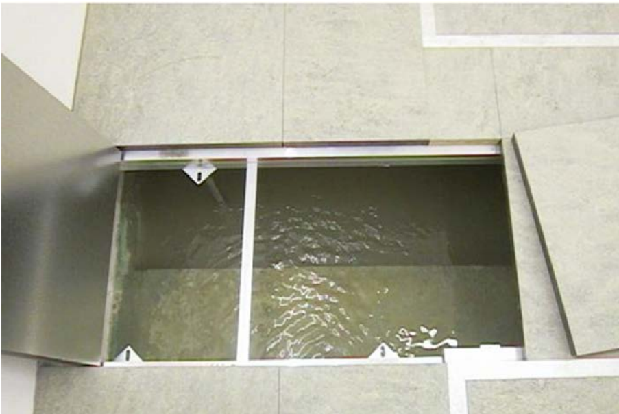
(10) Ein mit Wasser vollgelaufener Doppelboden
