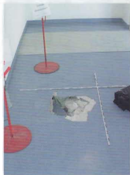
Bild 1: Einbruchstelle in eine Hohlbodenanlage nach dynamischer Belastung
