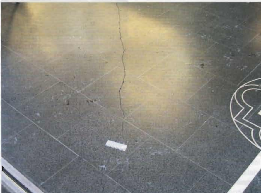
Bild 5: Riss an einem Verbund-Doppelboden (hier extreme Einzellast)
