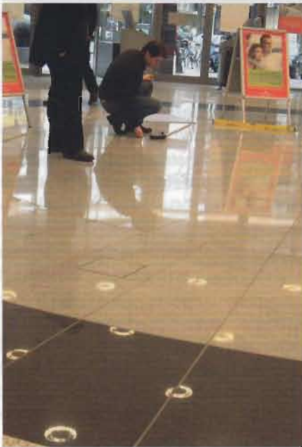
Bild 4: Erfassung der Rissverläufe an einem schadhaften Naturwerksteinbelag auf Verbund-Doppelboden (hier Einwirkung aus Deckenverformungen)
