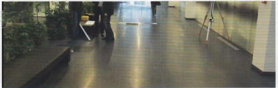
Bild 6: Erfassung der Rissverläufe an einem schadhaften Naturwerksteinbelag auf Verbund-Doppelboden (hier im Wesentlichen durch extreme klimatische Einflüsse im Bodenhohlraum und Bauwerkseinwirkungen)
