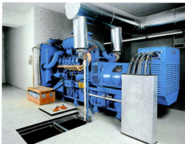
Systemböden bieten flexible Gestaltung von Labor- und Fertigungsflächen auch im Hochlastbereich - hier durch ein Notstromaggregat.
